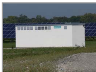
Bild 4: Betriebsgebäude für Wechselrichter und Trafostation
